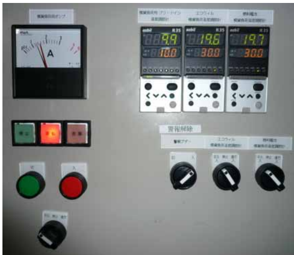
图 8.2.27 温水還温度 制御盤
