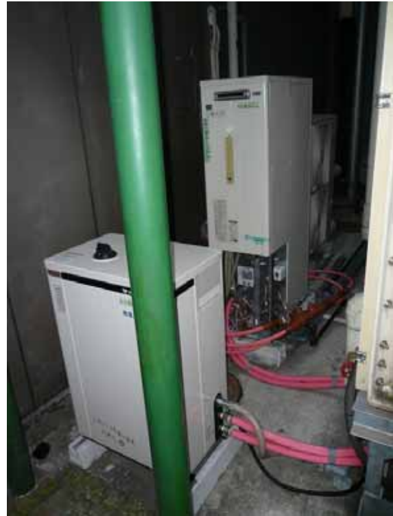
図 8.1.6 ガスエンジン 試験対象機
