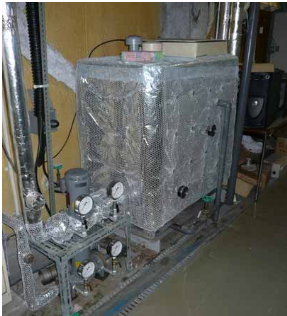
图 8.2.13 給水温度制御装置
