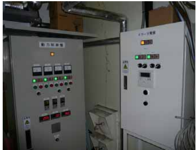
图 8.2.14 空調システムと温水制御装置の制御盤
