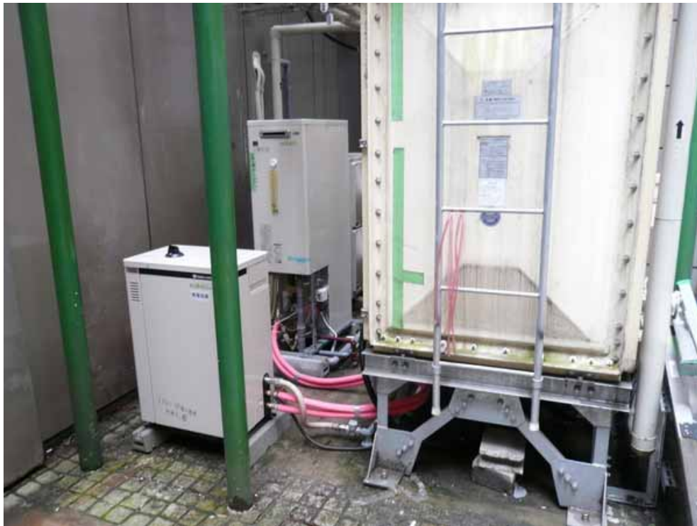
図 8.2.21 ガスエンジンコジェネレーション 評価サイト(屋外)
