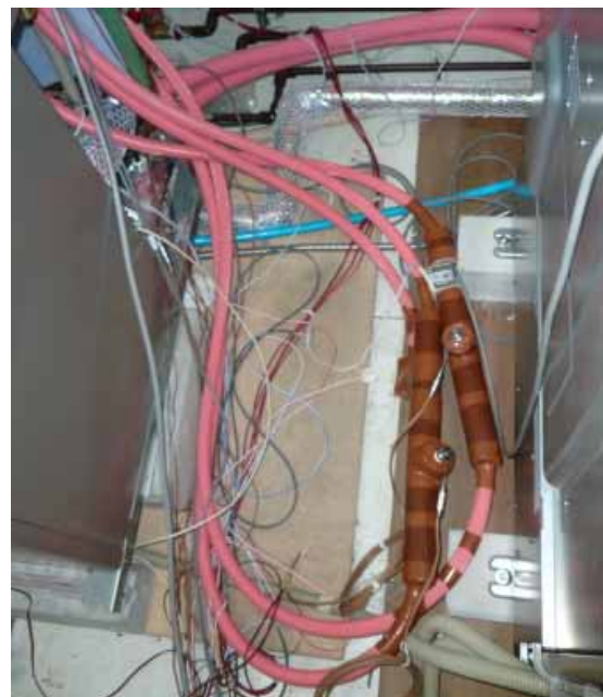
图 8.2.28 温水暖房回路周り 計測状況
